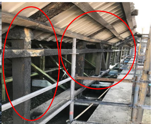
Figura 8: Daño crítico en columnas, vigas y puntales
