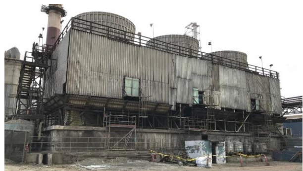
Figura 2 : Torre de enfriamiento
