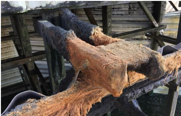
Figura 3: Degradación en elementos perimetrales
