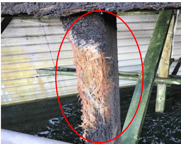
Figura 7: Pérdida de sección en columnas perimetrales
