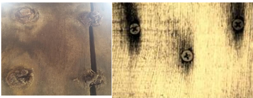
a) Degradação de conectores metálicos e formação de fissura em ligação estrutural de madeira.
