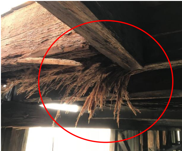
Figura 5: Pérdida de sección en vigas de soporte de equipos
