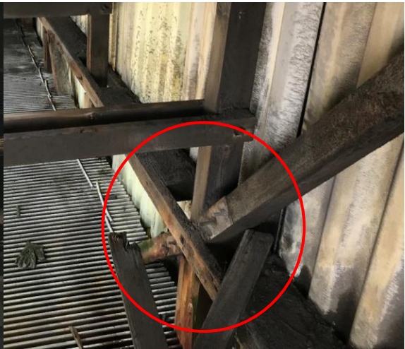
Figura 6: Corrosión y debilitamiento de uniones
