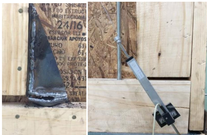
Figura 5: Fallas en los elementos de borde en anclaje “Hold Down” (izq); barra de acero (der).
