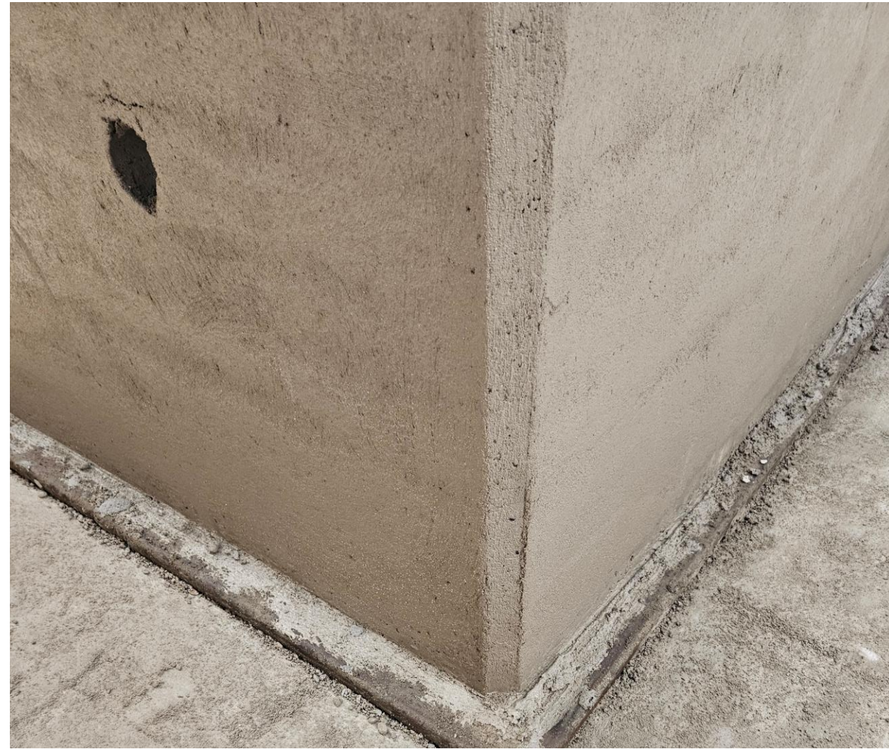
Hormigón con ACR
