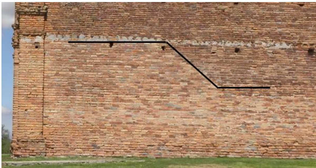
Figura 3.42. Perfil de cambio de coloración en la que se observa un “escalonamiento” ascendente sobre las fachadas Norte y Sur hacia la Fachada Este.
