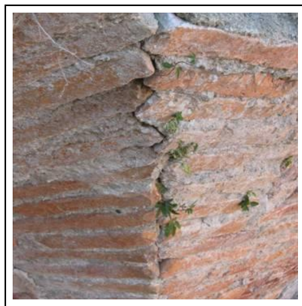
Figura 3.44. Detalle de encuentro de los planos concurrentes al ángulo de la sección de bóveda de apoyo de la bóveda mayor.
