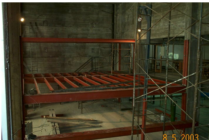
Construcción de un sector de los entresijos metálicos del Cuerpo Norte (mayo de 2003).
