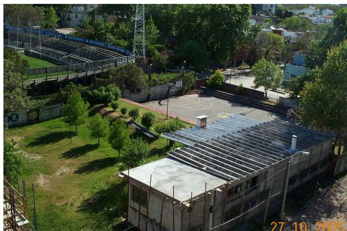
Foto de 2005: techo de hormigón en la cocina
