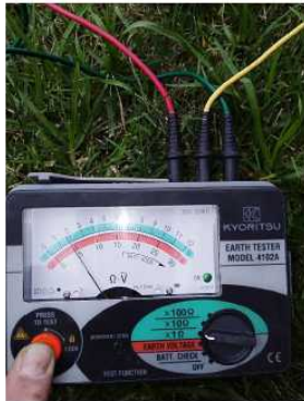
La medición de la resistencia de ésta puesta a tierra es de 2 Ω.
