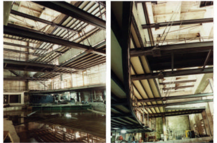
Readequación de la antigua Sala de Máquinas: Facultad de Ingeniería, Montevideo, Uruguay 4
